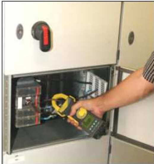
Sähkötehon mittaaminen pihtimittarilla ennen taajuusmuuttajaa
